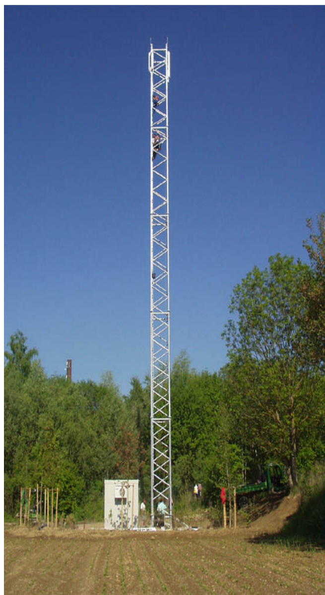
Billede: Gittermast med teknikkabine
